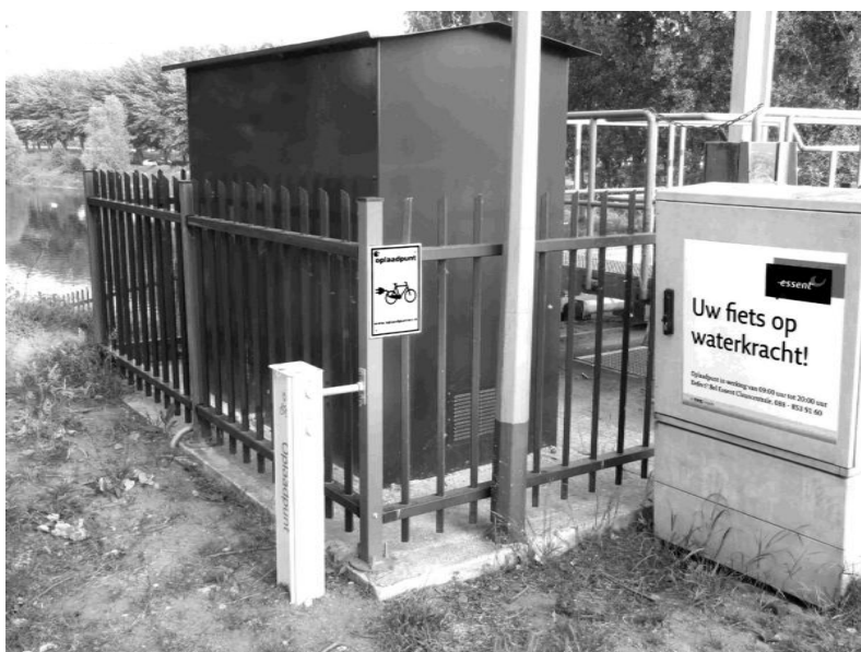
Oplaadpunt voor elektrische fietsen bij de Clauscentrale, de waterkrachtcentrale in de stuw bij Linne
