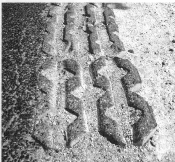
2. Redelijke bermverhardingselementen, fout gelegd
